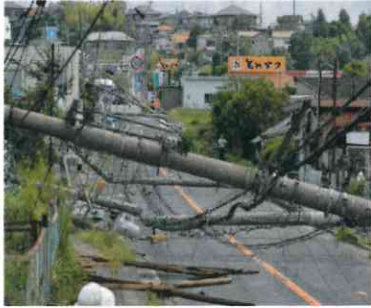
倒れた電柱写真 電気新聞デジタルより
